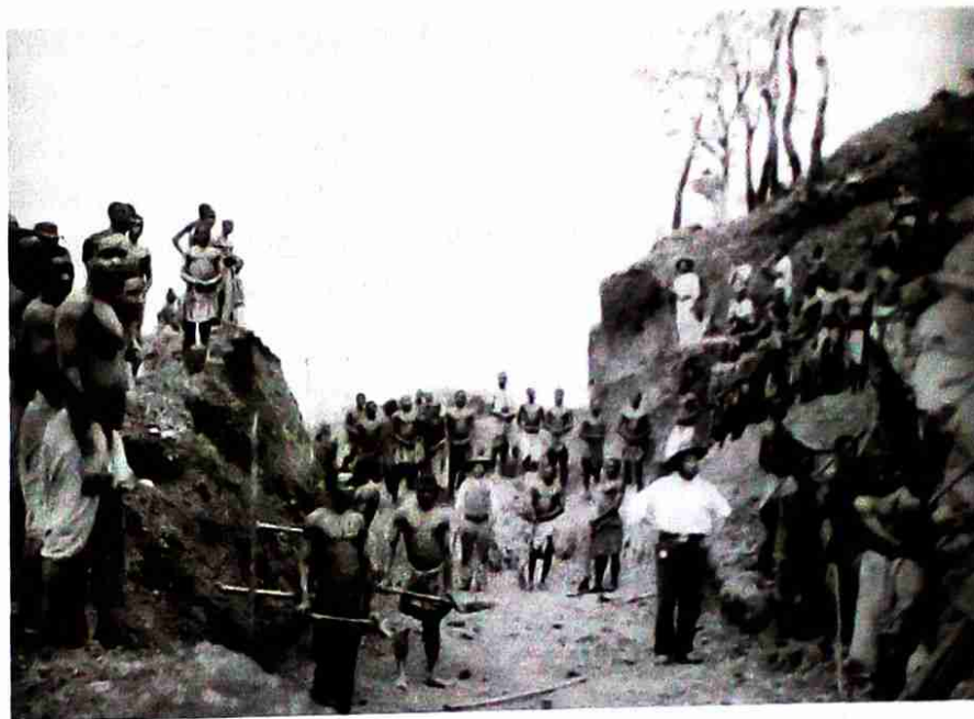
..... Fig. 24 Trabalhos de construção da Beira Railway Company , finais do século XIX.
