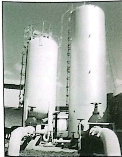
Fig. 6 Depósitos para conservação de água.
